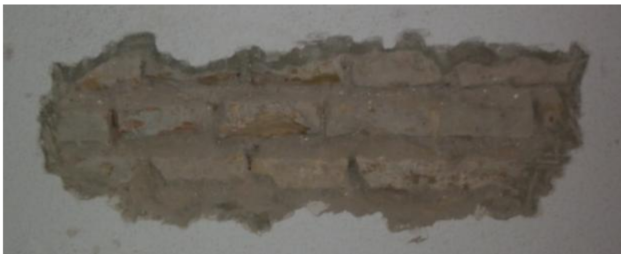
Cata CM.1B en cara interior de muro de fachada
