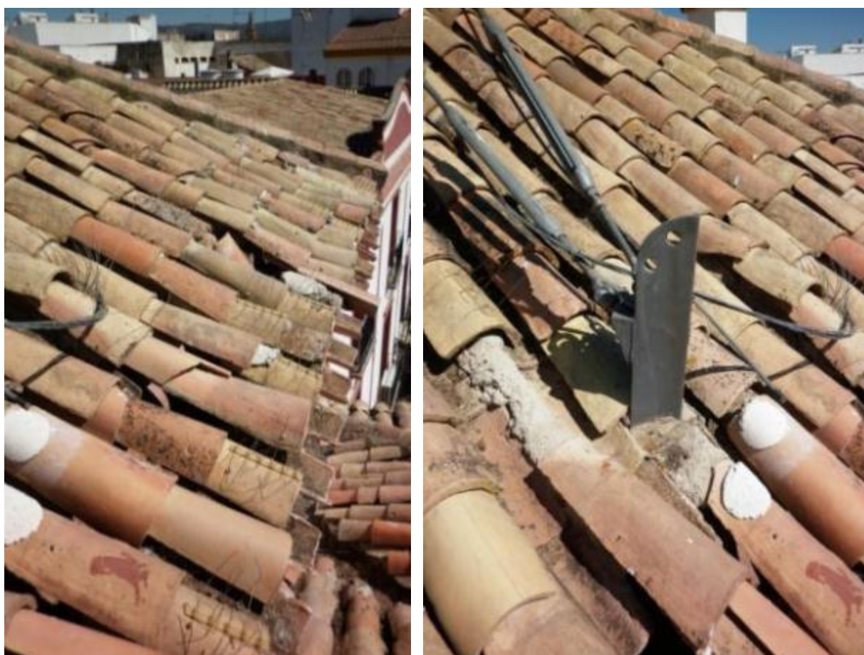
Hundimiento de teja cobija sobre el canalón y anclaje de antena.
