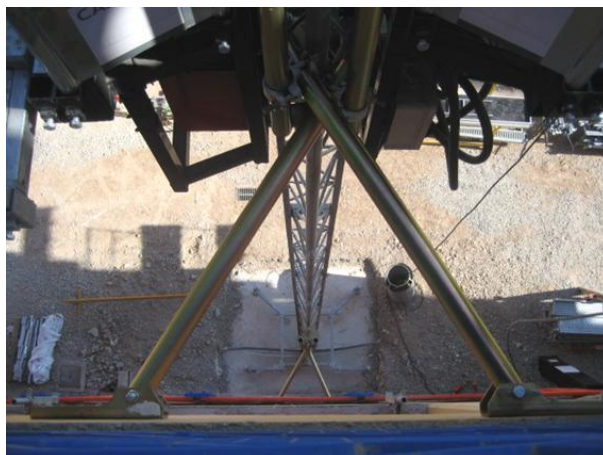
Detalle de anclaje de mástil en estructura
