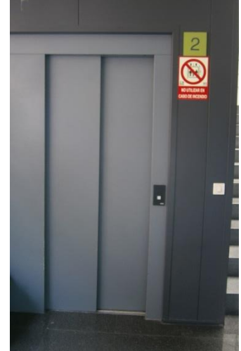
Figura 9 Ascensor en P2
