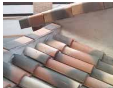
Fig. 4: fisura característica en la parte superior del borde lateral de una cubierta inclinada (bajo pieza especial de remate).
