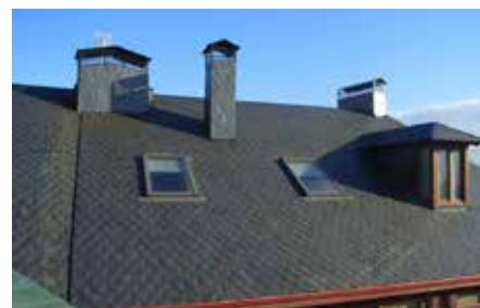
Fig. 6: tejado de pizarra con la existencia de distintos puntos singulares: canalones, ventanas, chimeneas, juntas de dilatación...
